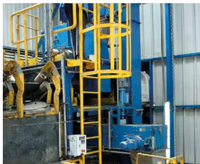
Installazione per il campionamento del concentrato di rame
