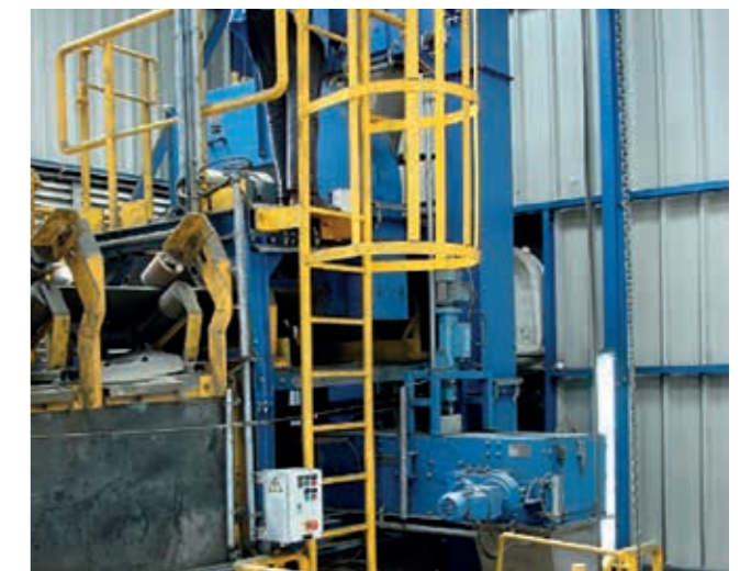
Probenahmeanlage für Kupferkonzentrat
